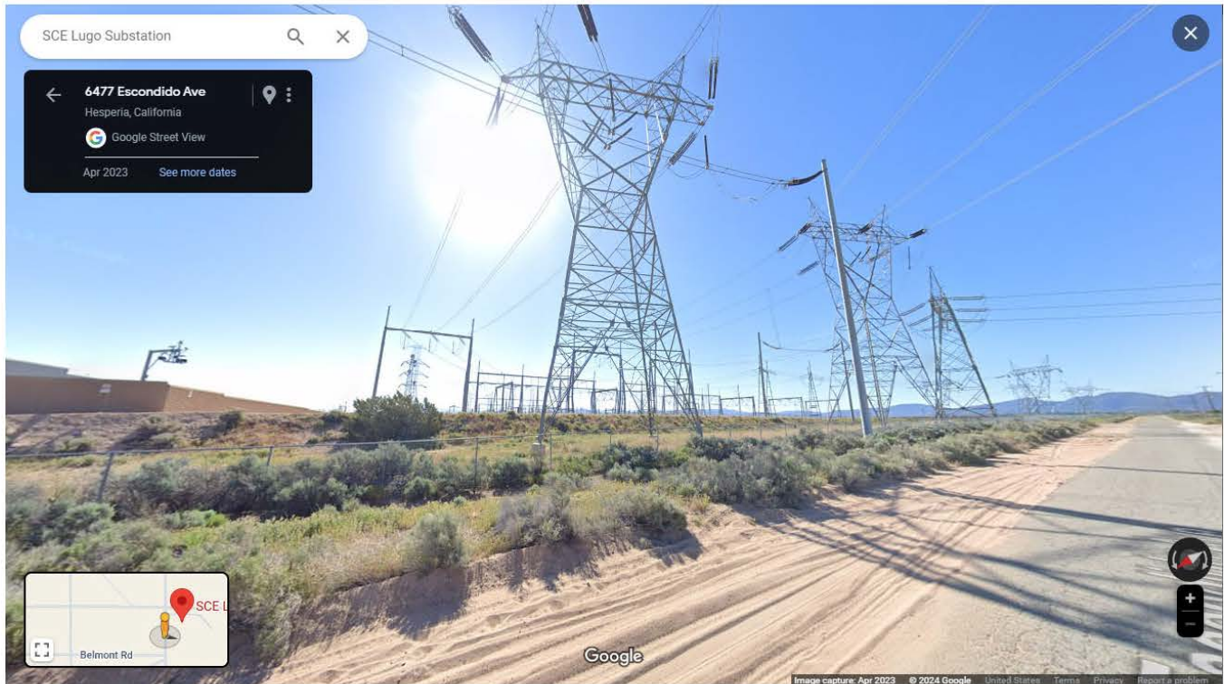
Figure 22 - SCE Lugo Substation
