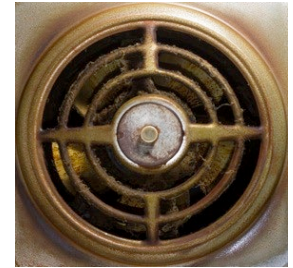
Wall exhaust fan
