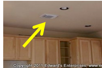
Ceiling exhaust fan
