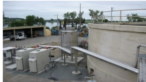
Las Gallinas Bioenergy Recovery System.
